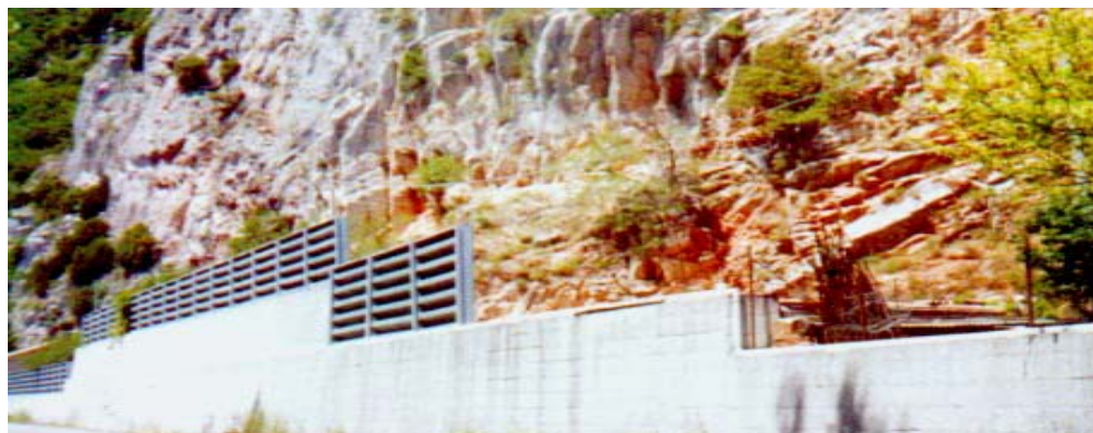
figura 18: Barriera paramassi rigida
