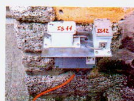
Inclinometro superficiale a muro
