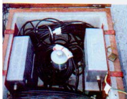
Testa di un tubo inclinometrico attrezzato con sonde fisse
